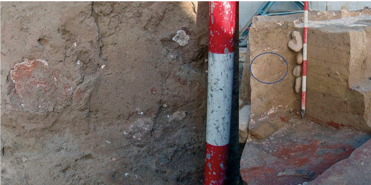
Figura 6. Vista en perspectiva y detalle de pintura sobre el enlucido de yeso en el alzado del muro sureste. (Foto: Cárceles, Soler y López, 2014)
