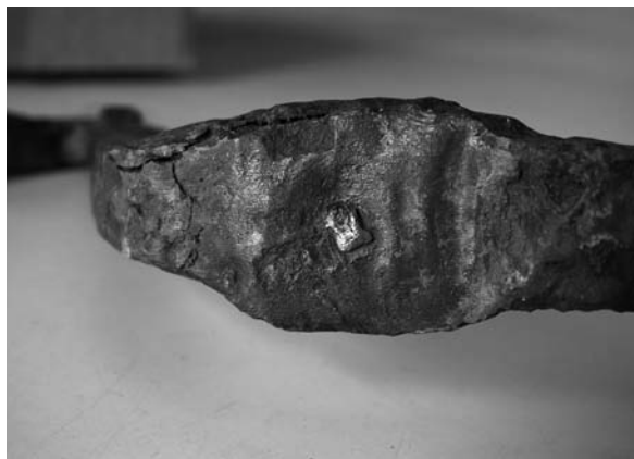
Figura 14. Pérdidas y desprendimiento de partes importantes por corrosión y ruptura de la espiga del remache.
