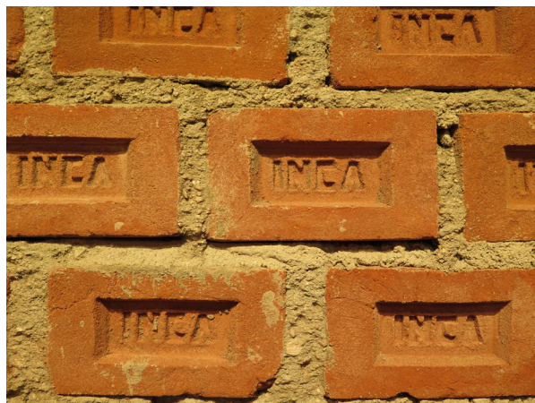
Fig. 7. Susana Torres Márquez, Muro Neo Inka (detalle). Ladrillos marca Inca, cemento marca Inca. Fragmento de instalación integrada a la muestra Re-decorando la huaca - Museo Neo Inka IX , Sala Luis Miró Quesada Garland, Lima.
