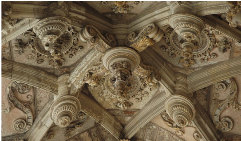
Fig. 10. León, claustro de la catedral, detalle del sistema de abovedamiento (Javier Ibáñez Fernández).
