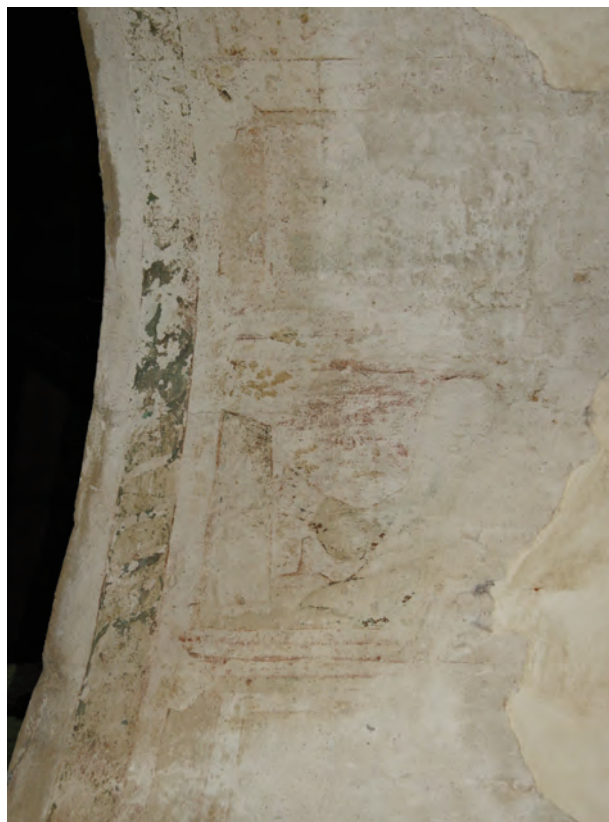
Fig. 3. Intradós del arco del acceso a la Capilla Dorada con restos pictóricos de bustos de profetas. Estado actual.
