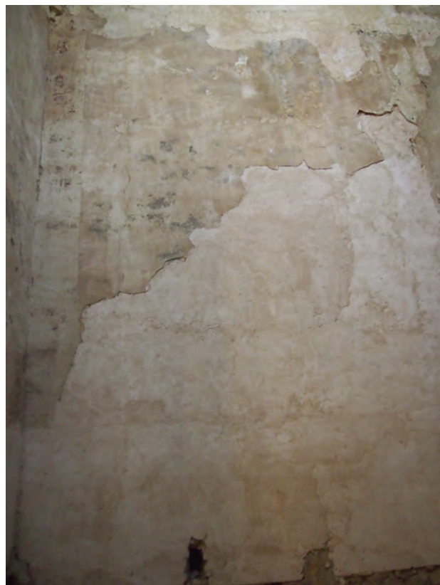
Fig. 4. Detalle de la pared este con restos pictóricos de las pilastras del marco arquitectónico. Estado actual.
