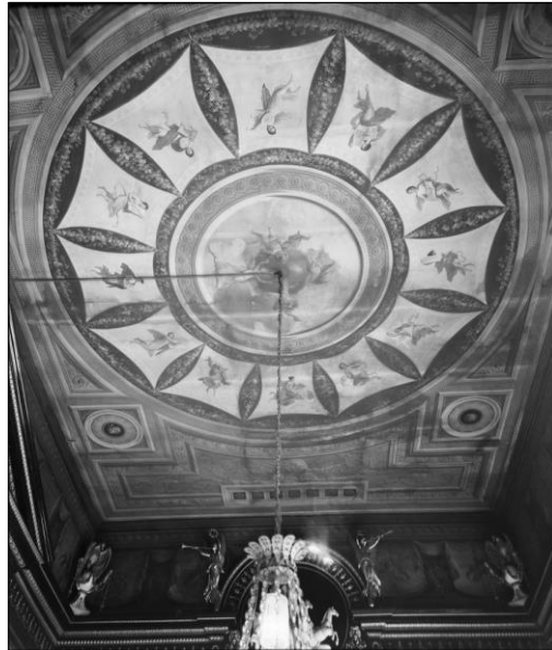
Fig. 26- Techo del Despacho de Godoy. Casa Moreno, “Archivo de Arte Español (1893-1953), Madrid. Ministerio de Marina, calle Prado nº 3”. Archivo Moreno nº inv. 35088_B. IPCE, MCD.
