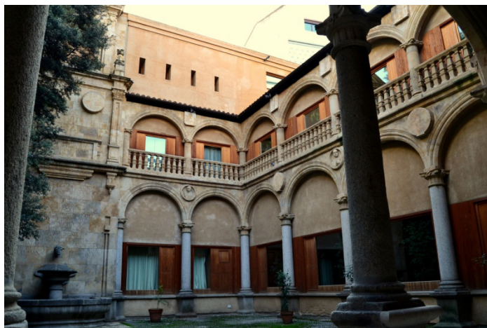
Figura 13: Aspecto del patio tras la última reforma: observamos el imafronte y las dos arquerías más modernas. Fuente: fotografía del autor.
