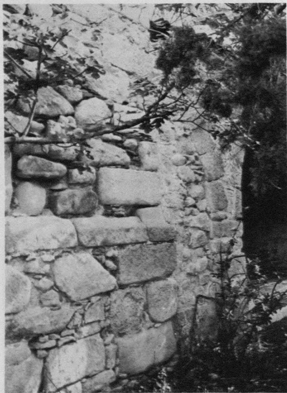
Lám. 12. Detalle del arco cegado del pórtico y cuerpo inferior de la torre.
