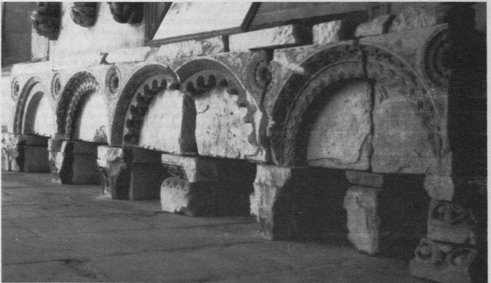
Fig. 2. Oña. Frontal del refectorio. Estado actual en la panda norte del claustro.
